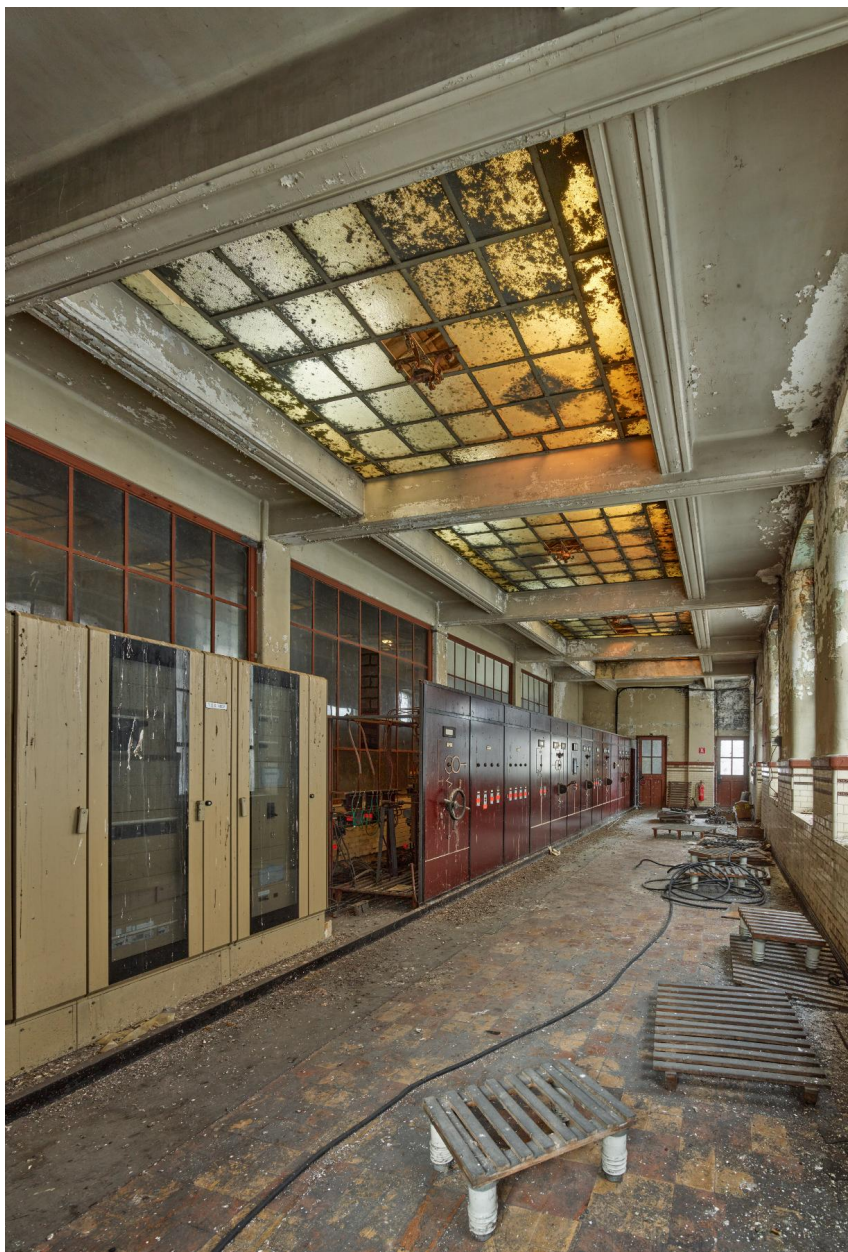
Intérieur de la salle des générateurs électriques, vue vers le nord.
