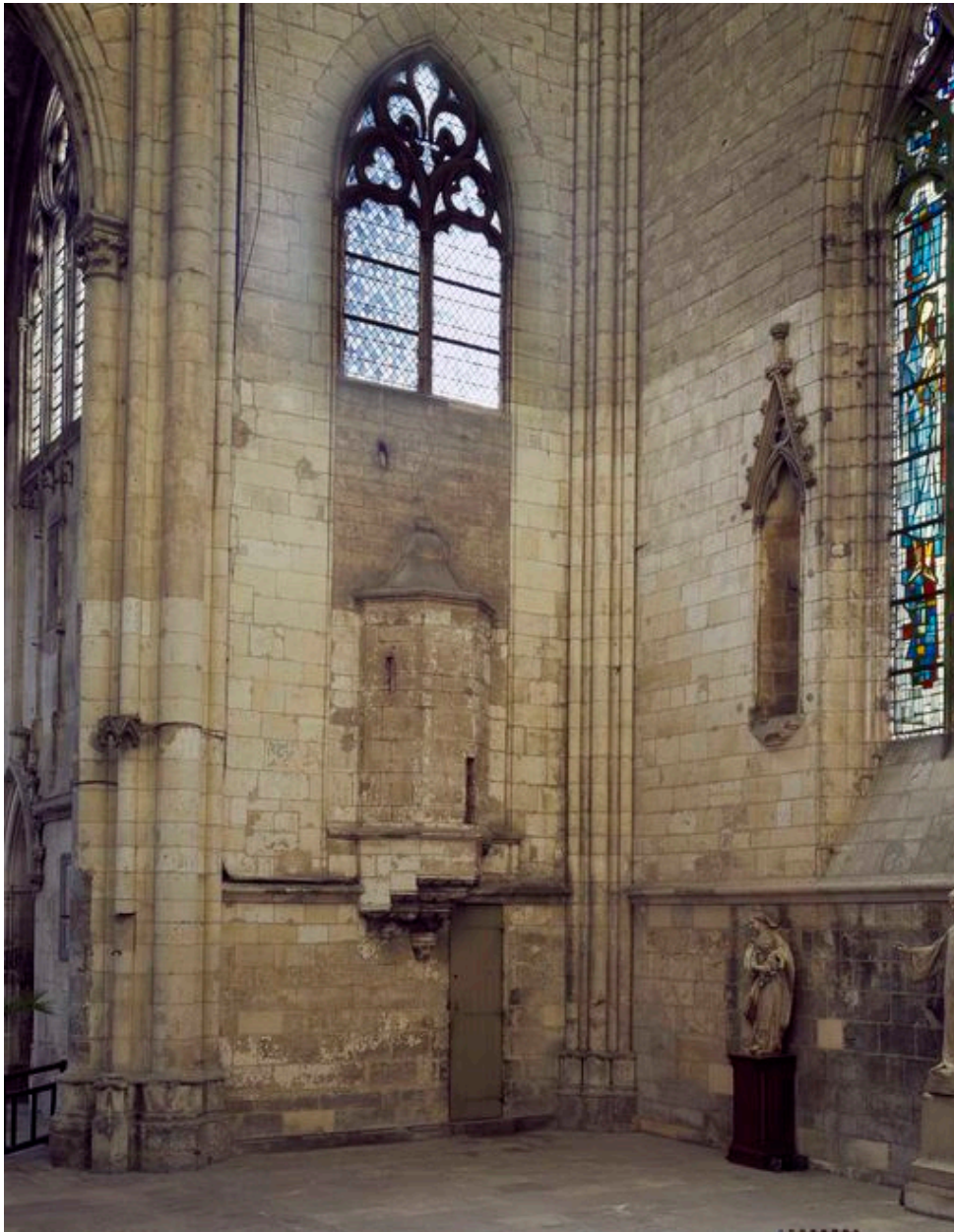
Bras nord du grand transept : tourelle de l'escalier du logement du sonneur de cloches.
