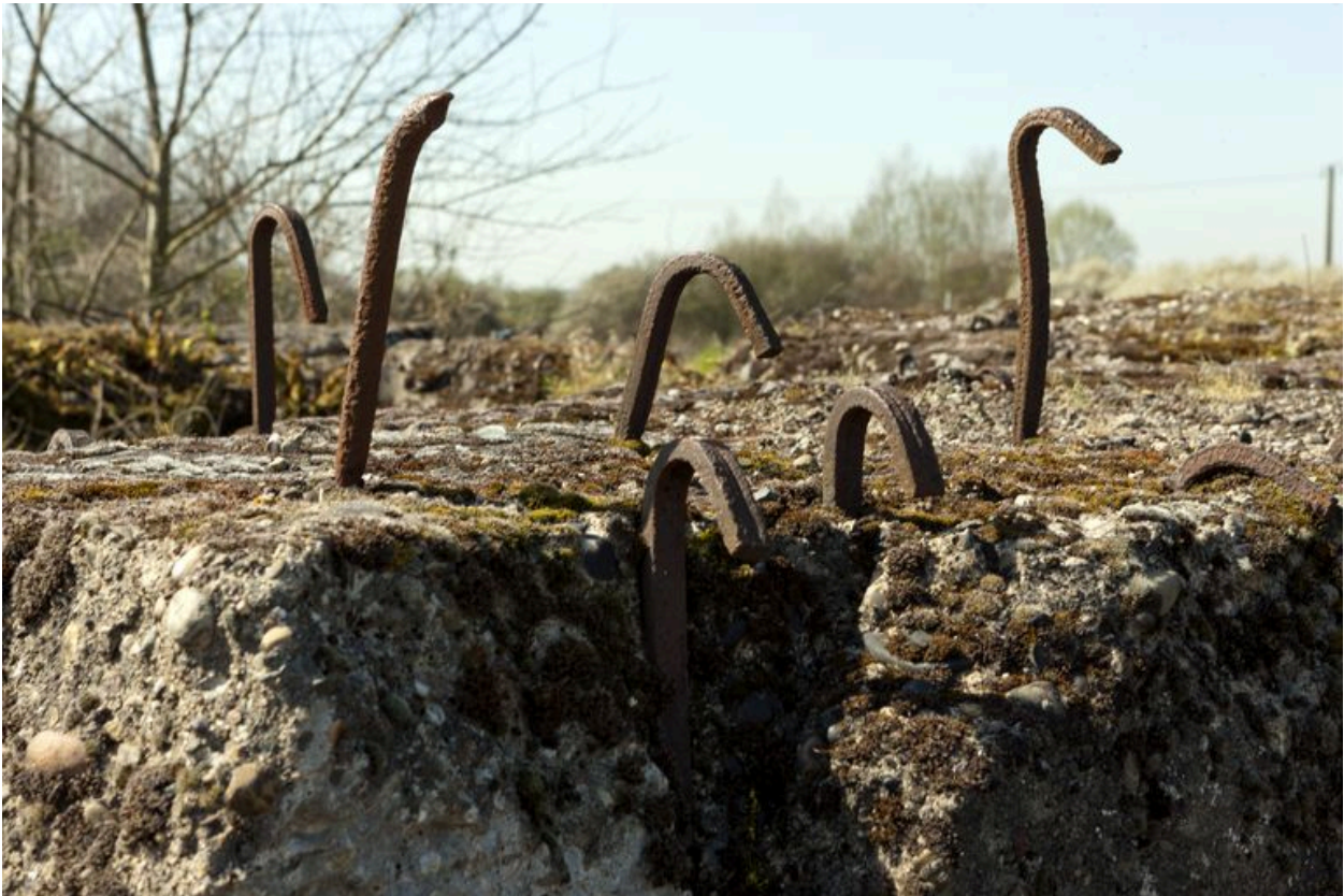
Bâtiment A : Partie explosée du toit, détail du ferrailage
