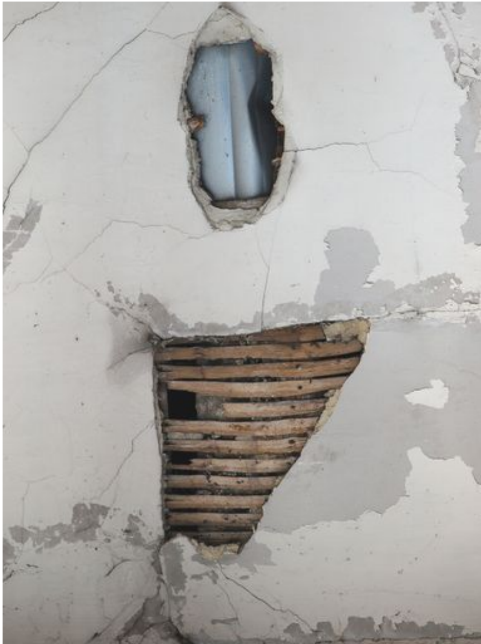
Désordres dans la voûte en plâtre sur lattis au niveau de la tribune d'orgue (partie sud)
