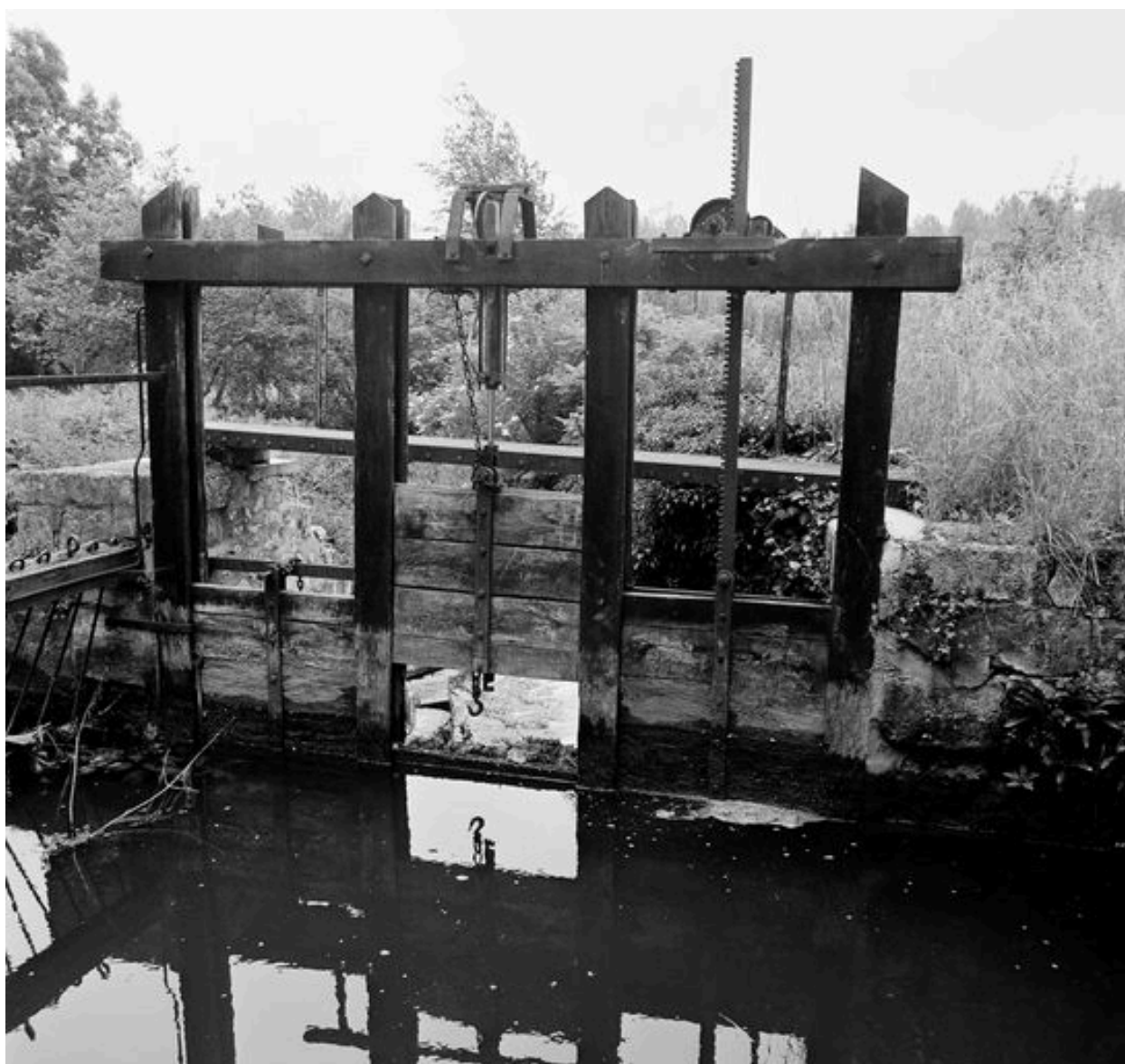
Vannes de décharge.
