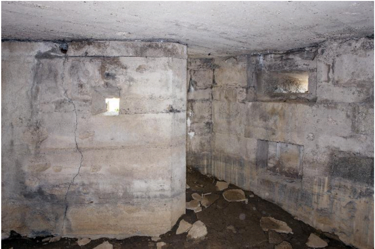
Salle est. couloir de sortie en chicane avec son créneau de tir.
