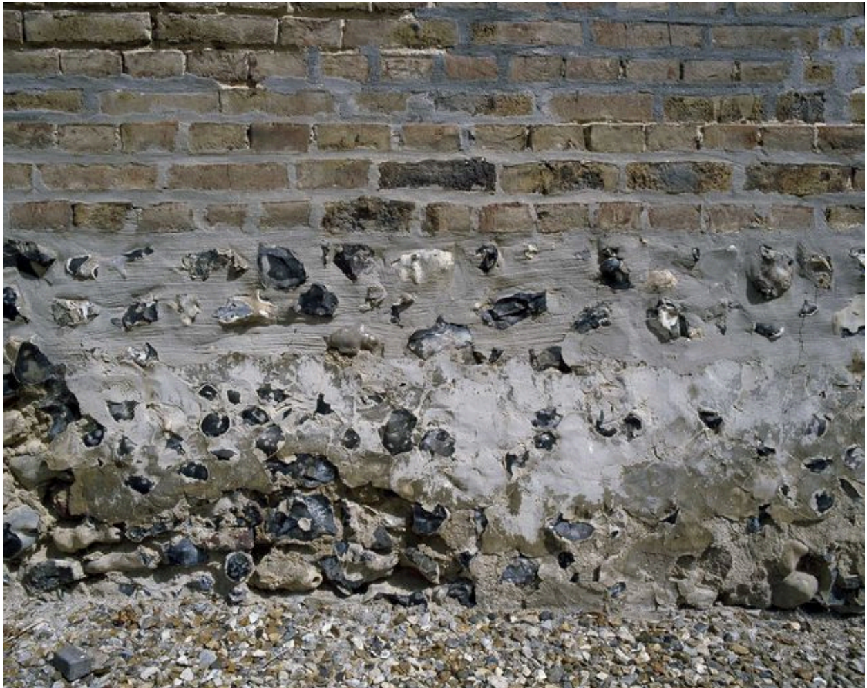
Détail de l'appareil en silex de la base du mur de la nef.
