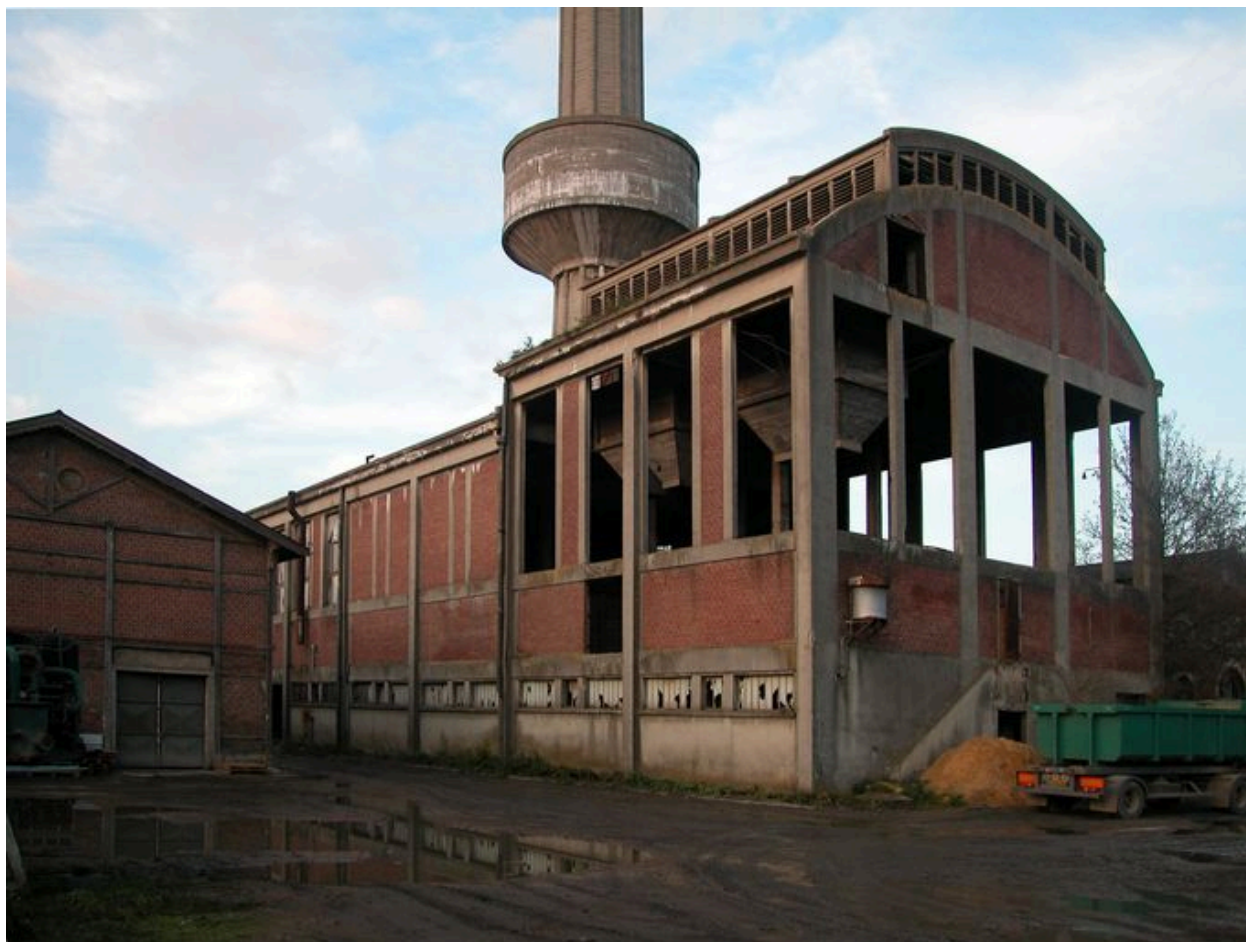
La chaufferie thermique, vue d'ensemble.
