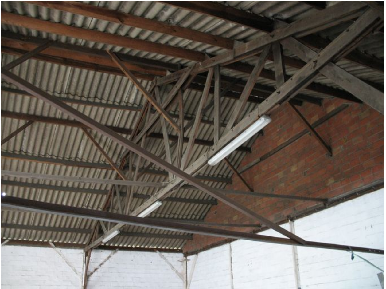
Détail de la charpente en bois du magasin de stock des fûts.
