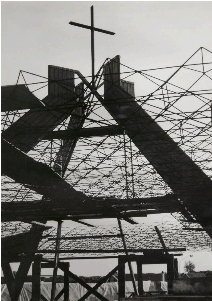
L'édifice en cours de construction. Vue de la charpente et de la résille en métal. Photographie, vers 1970. AP Jean XXIII, Saint-Quentin.
