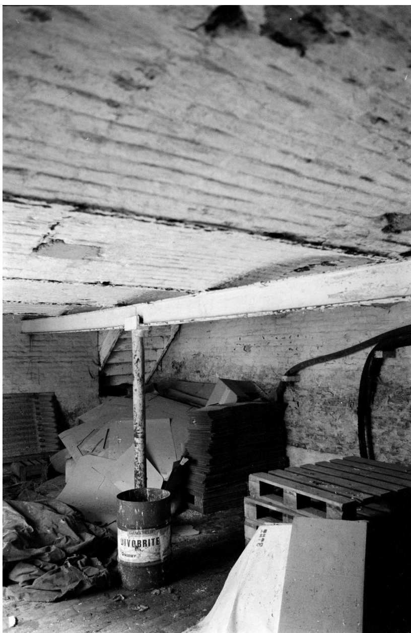
Sous-sol de la brasserie. Support de cuve de fermentation.
