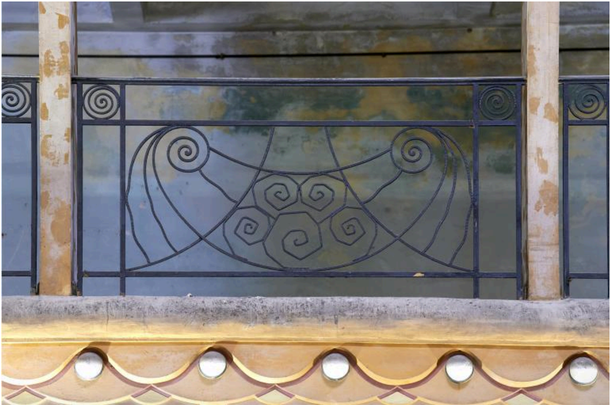
Détail du garde-corps en ferronnerie du premier étage autour du grand atrium principal.
