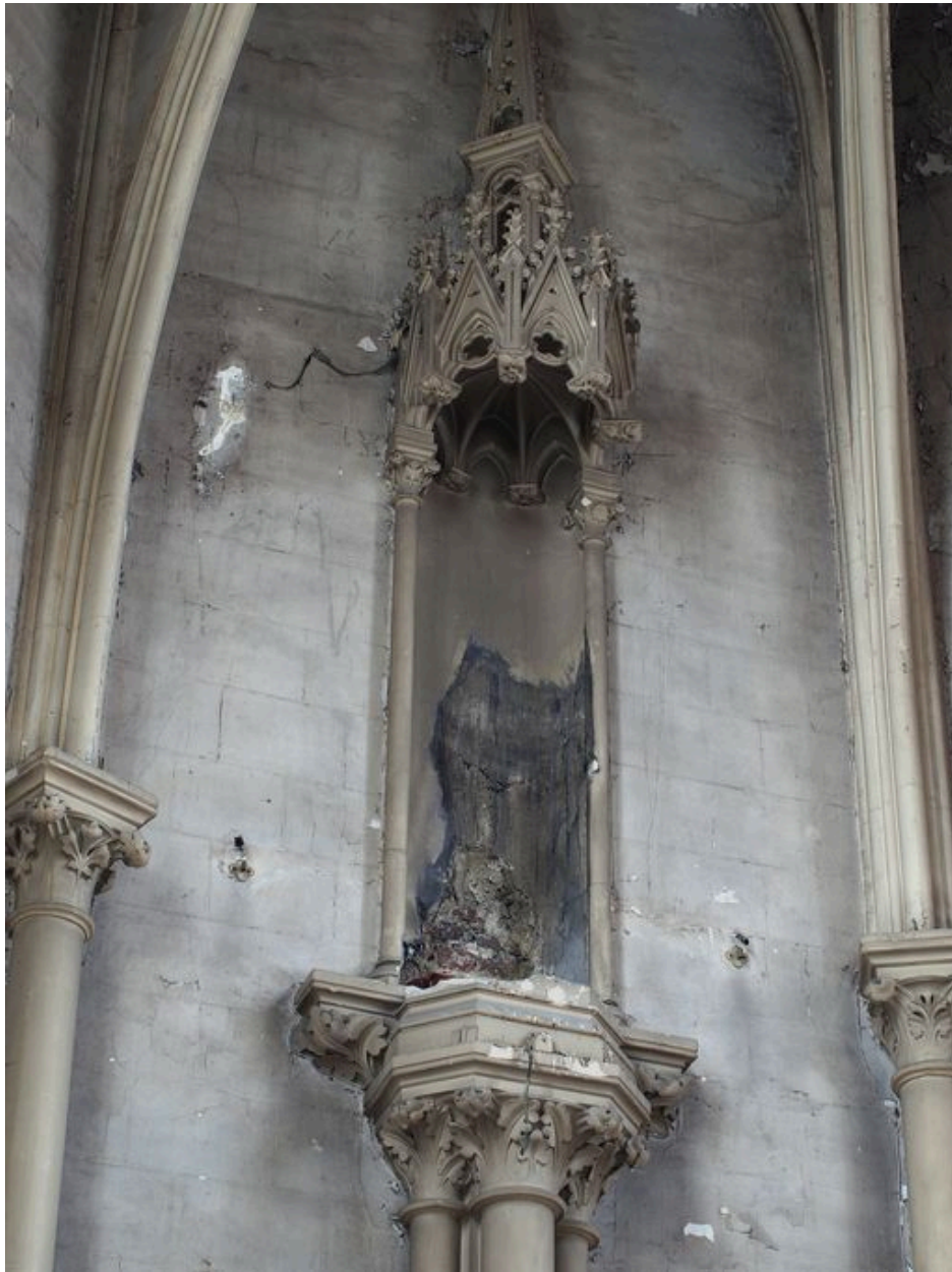
Chapelle, intérieur : emplacement de la statue (plâtre ?) d'axe de l'abside.
