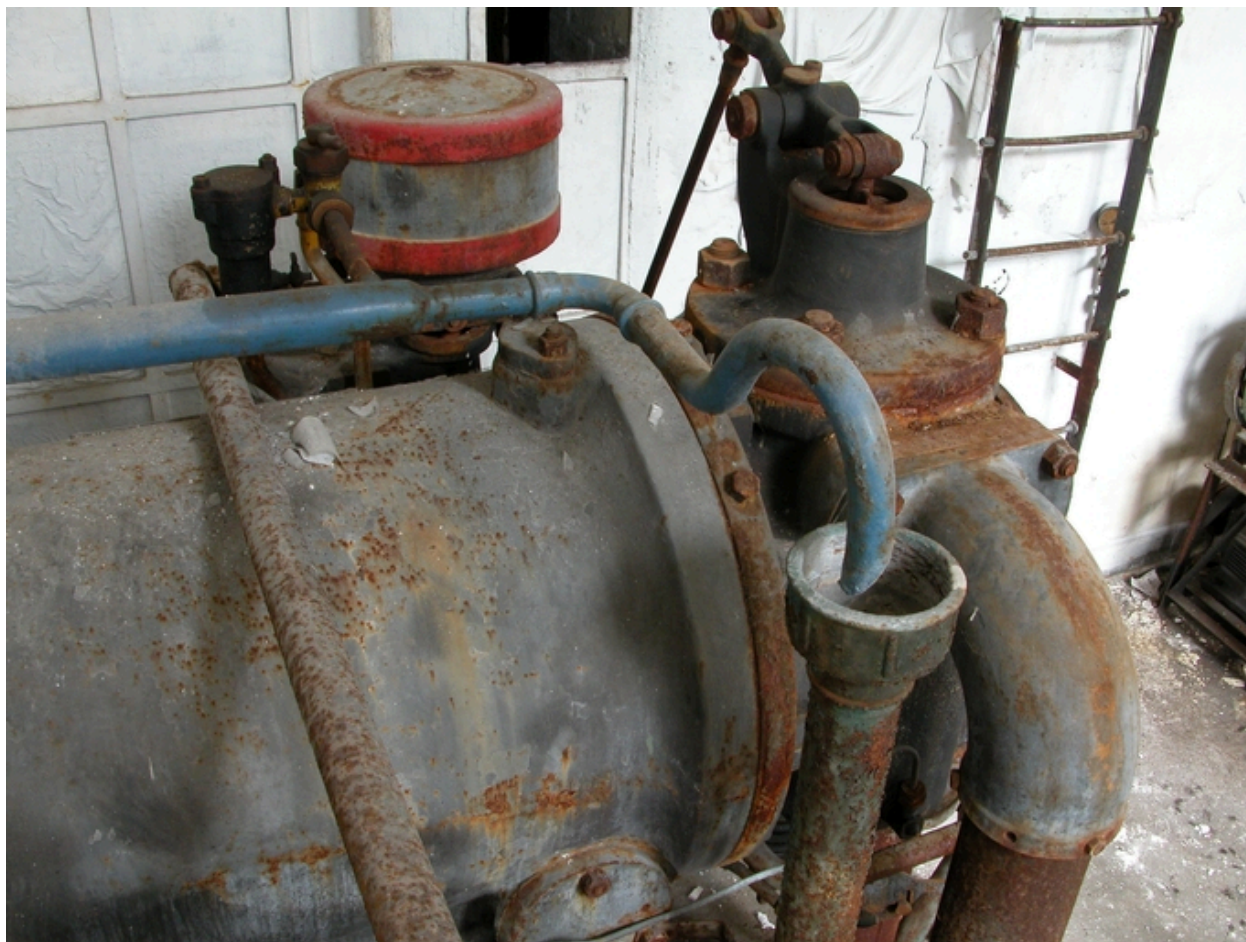
Régulateur, système d'admission et échappement des gaz de l'un des deux moteurs.
