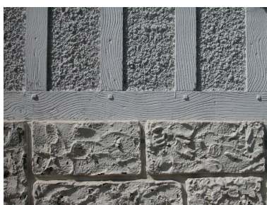
Détail du revêtement de la maison située 86 rue Anguier-du-Peuple (1969 AI 278). Phot. Elisabeth Justome IVR22_20058002885NUCA
