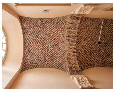
Détail du voûtement du couloir longeant la bibliothèque et menant à l'ancien cloître (actuel CDI du lycée). Phot. Pierre Thibaut IVR32_20225900236NUCA
