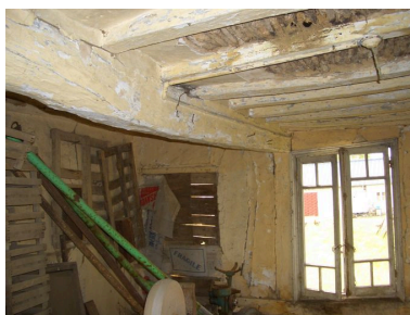
Vue intérieure de l'atelier. Phot. Inès Guérin IVR22_20068005742NUCA
