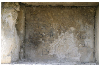
Détail actuel de l'état d'une des deux plaques. Phot. Inès Guérin IVR22_20030202693NUCA
