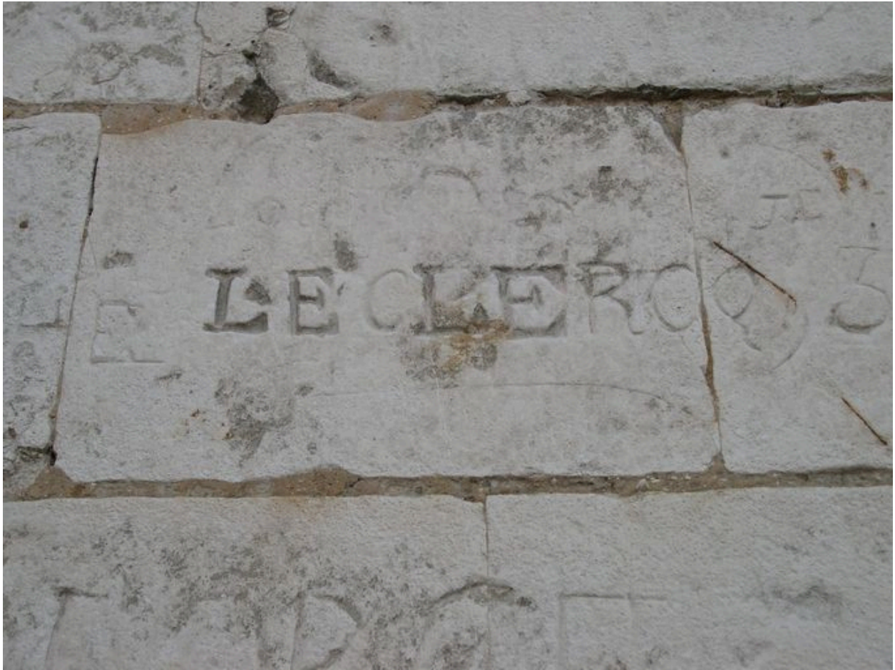
Mur nord du bas-côté nord : Graffiti.
