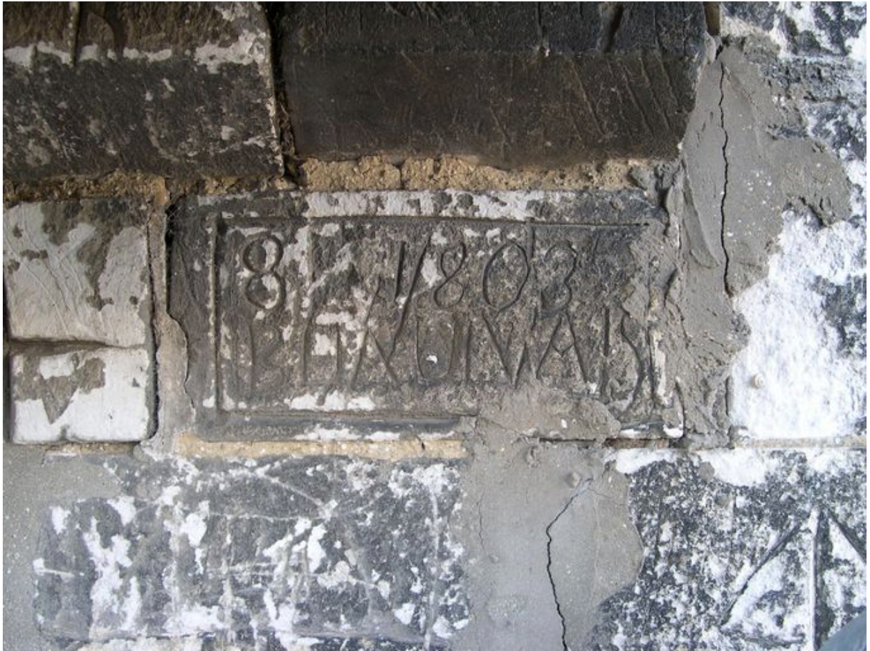
Mur nord du bas-côté nord : Graffiti.
