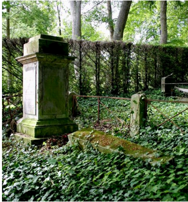
Pilier en forme d'obélisque (déposé), vers 1836, Lefebvre- Facquet entrepreneur. Phot. Caroline Vincent IVR22_20078000933NUCA
