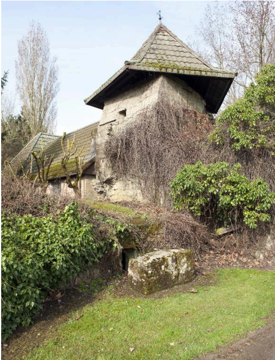
Vue générale vers le nord-ouest. A gauche de la tour, l'accès à la casemate à personnel avec son mur par-souffle
