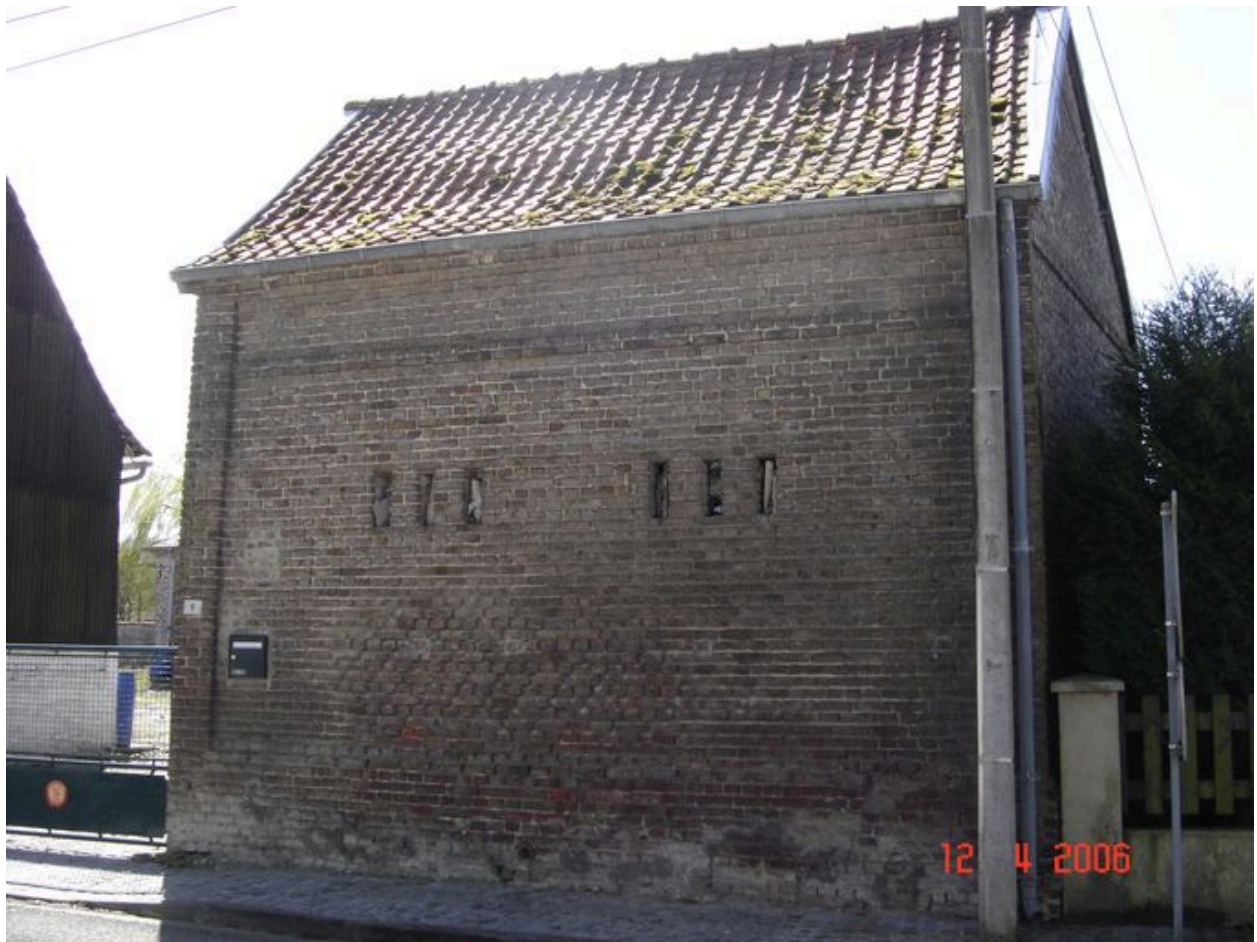
Vue des étables en brique à l'ouest de la cour depuis la rue.
