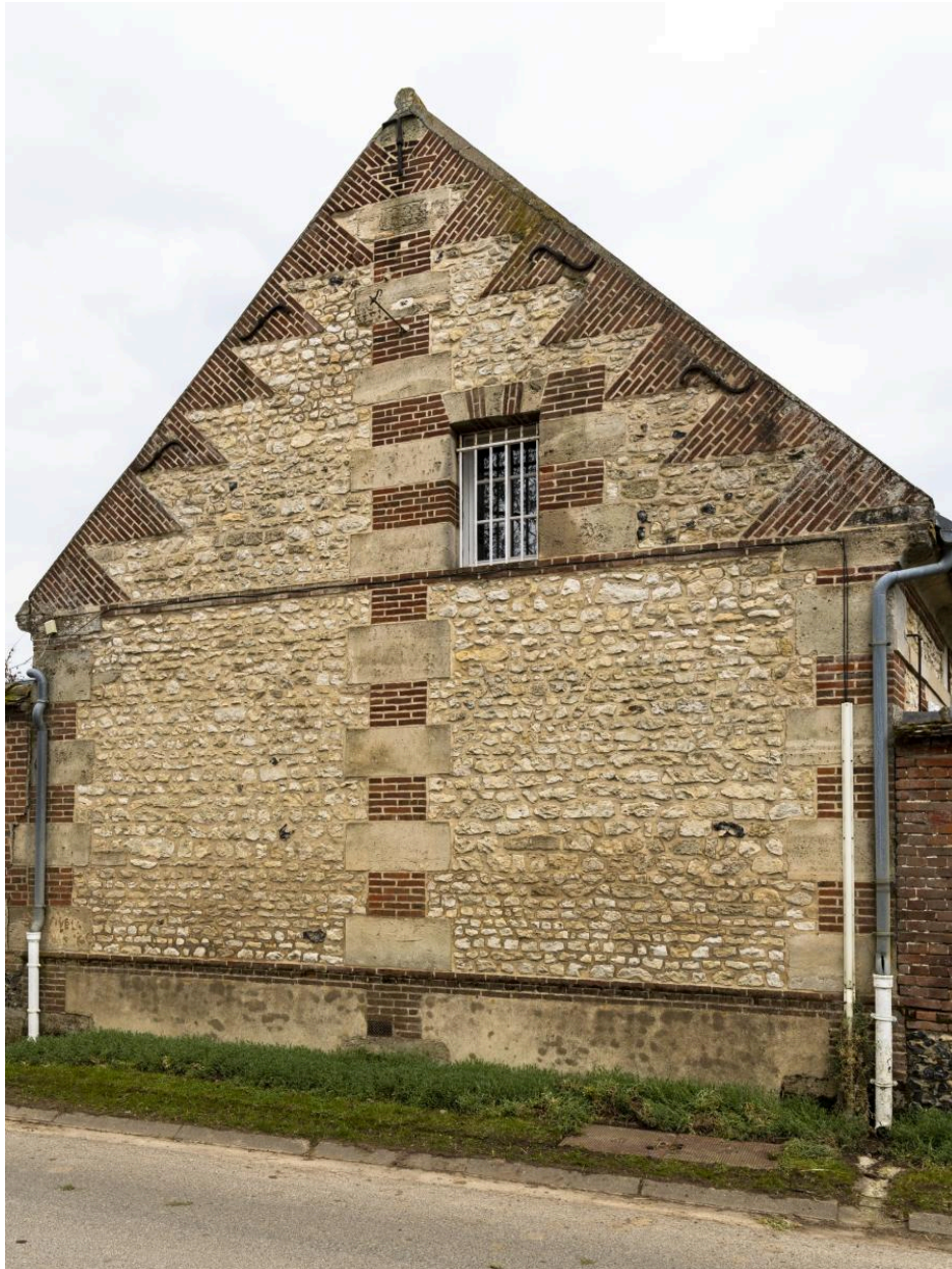
Pignon de logis en brique et pierre avec couteaux picards, n°2 rue de Boursines, vue depuis le nord.
