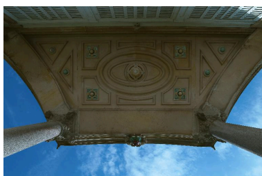
Vue de détail sur le décor du porche du jardin d'hiver. Phot. Marie-Laure Monnehay-Vulliet IVR22_20148000764NUC2A
