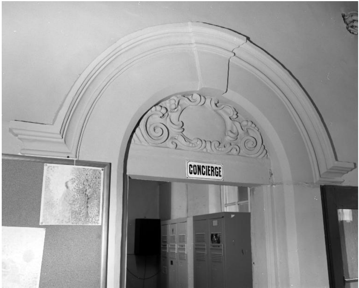
Conciergerie et bureau des entrées : détail de l'encadrement sculpté des ouvertures intérieures.
