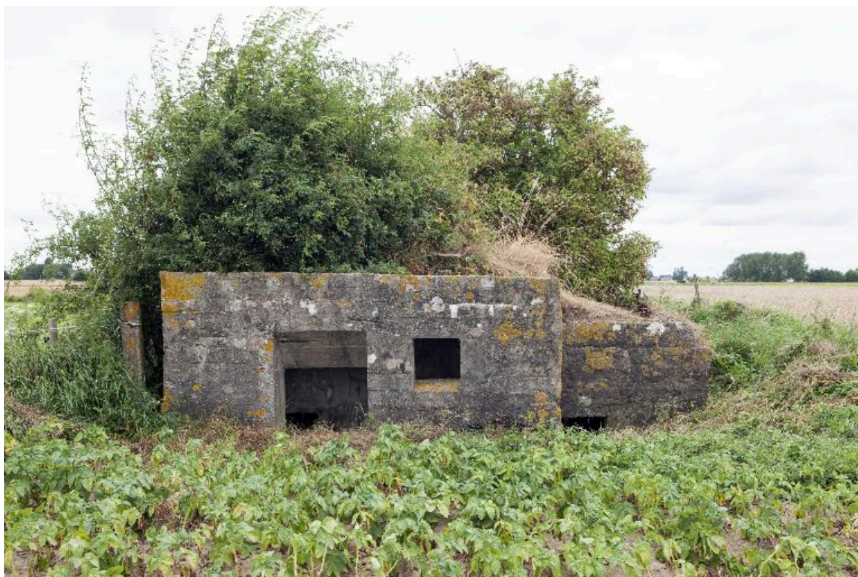
Elévation antérieure. A gauche l'entrée de la casemate, à droite, la soute à munitions (?)
