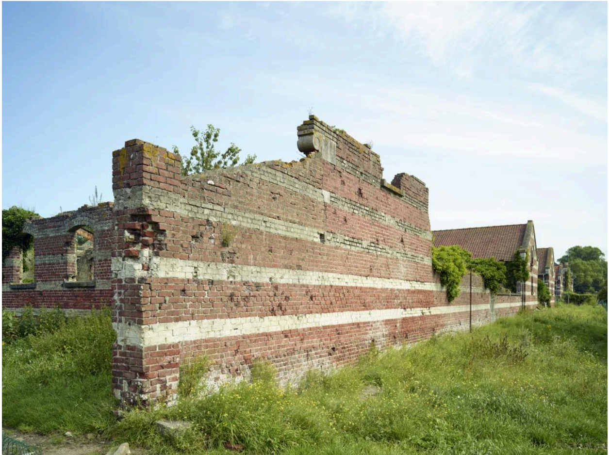
Mur de cloture sud de la ferme avec des pignons des bergeries et porcheries en prolongement.
