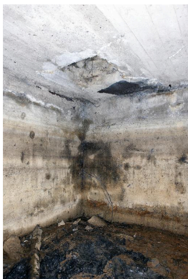
Salle S8, accès à la la tour de communication optique Phot. Pierre Thibaut IVR31_20155901430NUCA
