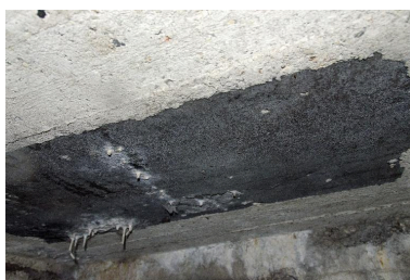
Salle S8, plaque métallique au plafond Phot. Jean-Marc Ramette IVR32_20175900519NUCA
