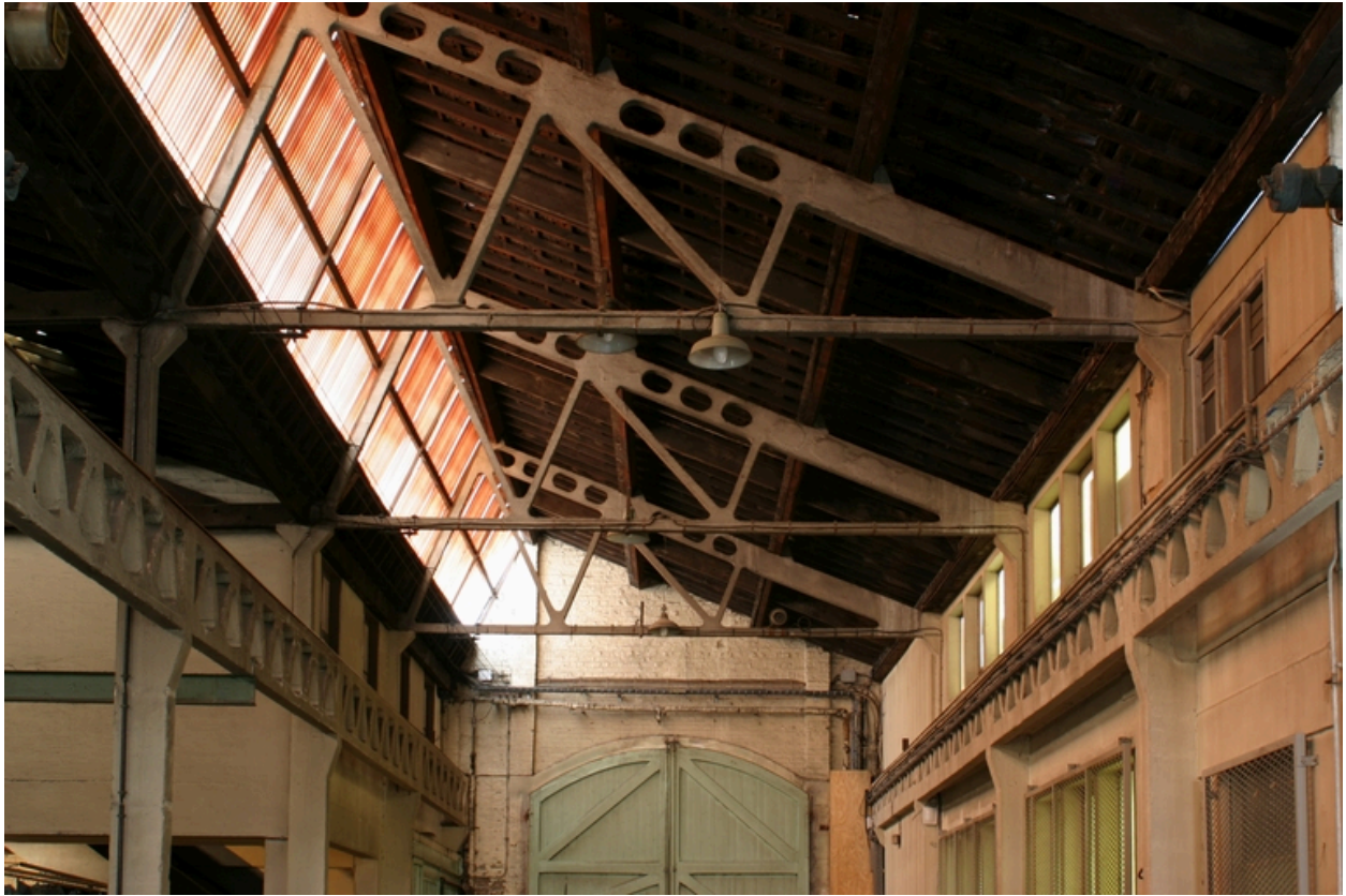
Ancien atelier de mécanique : détail de la structure porteuse et de la charpente, en béton armé.
