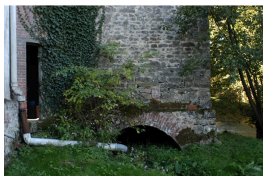
Détail de la coulerie sous cage maçonnée, face est. Phot. Thierry Lefébure IVR22_20036000294NUCA
