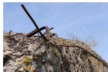
Partie est, détail du béton et des fers. Trois fers différents sont ici visibles. Phot. Jean-Marc Ramette IVR31_20145904861NUCA
