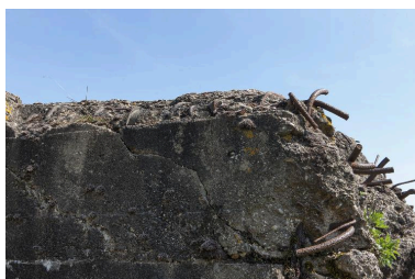
Partie est, détail du béton et des fers Phot. Jean-Marc Ramette IVR31_20145904859NUCA
