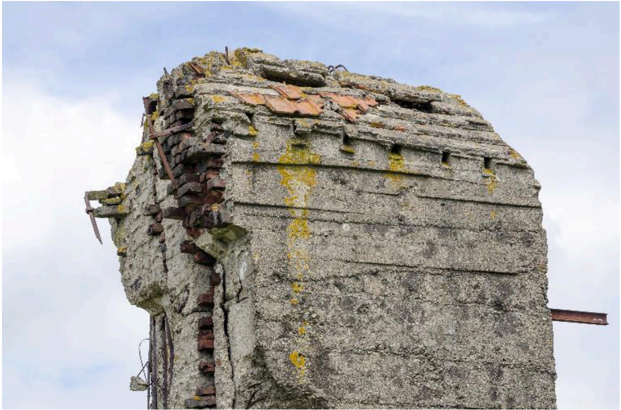
Couvrement de l'observatoire, vers l'est. On aperçoit les deux embrasures d'observation près du faîtage.
