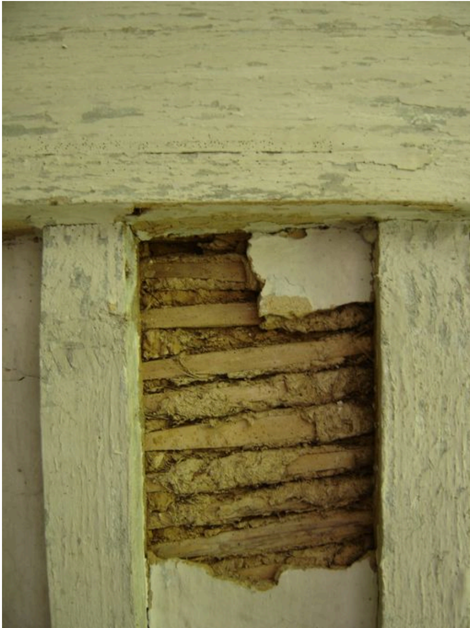
Détail de la composition du plafond des boxes en torchis enroulé autour de lattes placées entre les solives.
