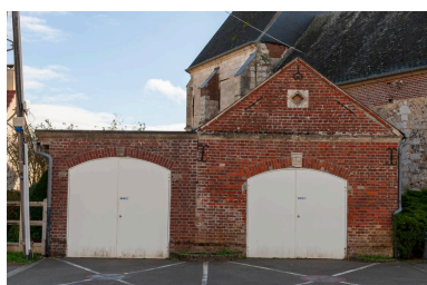
Remise des pompes à incendie, 1854 et 1954 (dates portées), vue depuis l'ouest. Phot. Marc Kérignard IVR32_20226001143NUCA
