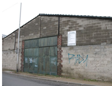
Entrée de la petite halle sur la rue Stéphenson. Phot. Clarisse Lorieux IVR22_20076005175NUCA
