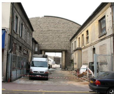
Avril 2007 : début de la démolition de la façade rue Jules Juliet. Phot. Clarisse Lorieux IVR22_20076005206NUCA
