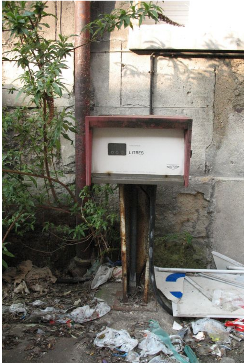
Pompe à essence située dans la cour des entrepôts.
