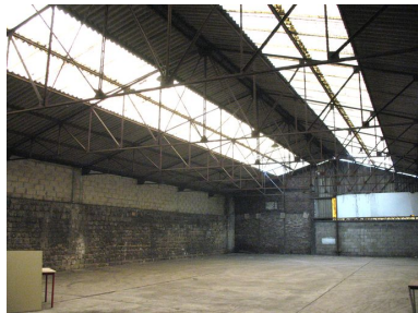
Vue générale de la petite halle et de sa charpente. Phot. Clarisse Lorieux IVR22_20076005169NUCA
