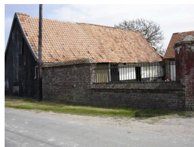
Vue sur les étables en pans de bois hourdé au torchis. Phot. Catherine Fourmond IVR22_20058001512NUCA
