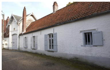
Le portail et l'aile abritant les communs transformés en logements ouvriers. Phot. Pierre Thibaut IVR31_20095903387NUCA
