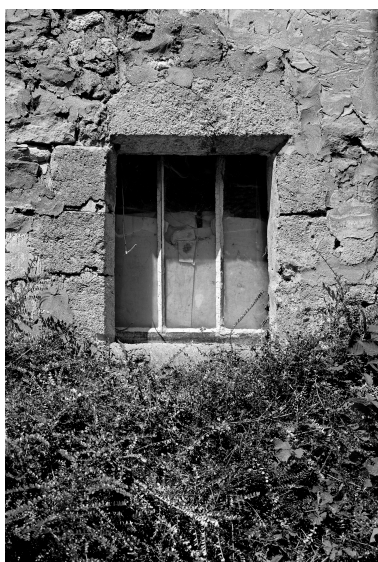
Fenêtre du rez-de-chaussée : vue de la cour intérieure. Phot. Thierry Lefébure IVR22_19950203307V
