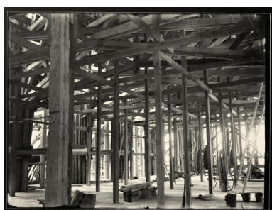
Faux plancher et ouvrage en charpente permettant de restaurer les parties supérieures de l'église (photographie de l'entre-deux-guerres). Phot. Jean-Michel Périn (reproduction) IVR22_19840200057XB
