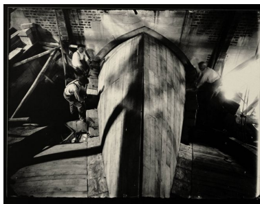
Réfection de l'extrados des voûtes du vaisseau central ou des transepts. Phot. Jean-Michel Périn (reproduction) IVR22_19840200070XB
