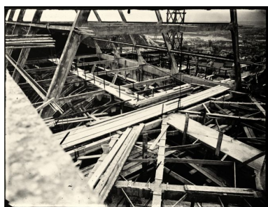
Pose de la charpente du vaisseau central (photographie de l'entre-deux-guerres). Phot. Jean-Michel Périn (reproduction) IVR22_19840200053XB
