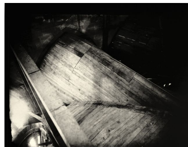
Détail de la réfection de voûtains du vaisseau central ou des transepts (photographie de l'entre-deux-guerres). Phot. Jean-Michel Périn (reproduction) IVR22_19840200054XB
