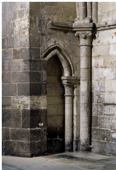
Arc ornant le mur occidental du rez-de-chaussée du clocher-porche. Phot. Thierry Lefébure IVR22_20100200150XA
