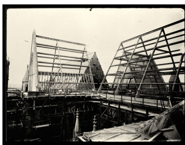
Reconstruction de la charpente du grand transept et du chœur (photographie de la première moitié des années trente). Phot. Jean-Michel Périn (reproduction) IVR22_19840200058XB
