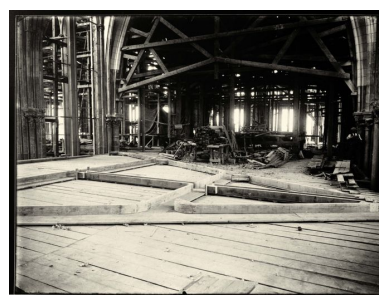
Vue d'une ferme de la charpente (photographie de l'entre-deux-guerres). Phot. Jean-Michel Périn (reproduction) IVR22_19840200071XB
