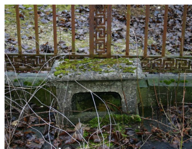
Banc en pierre, à usage de bouche d'aération du caveau. Phot. Caroline Vincent IVR22_20068000638NUCA
