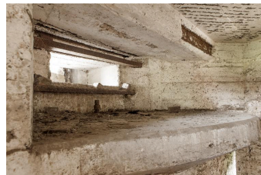
Rez-de-chaussée, appui pour mitrailleuse et embrasure de tir ouest Phot. Jean-Marc Ramette IVR31_20145904837NUCA
