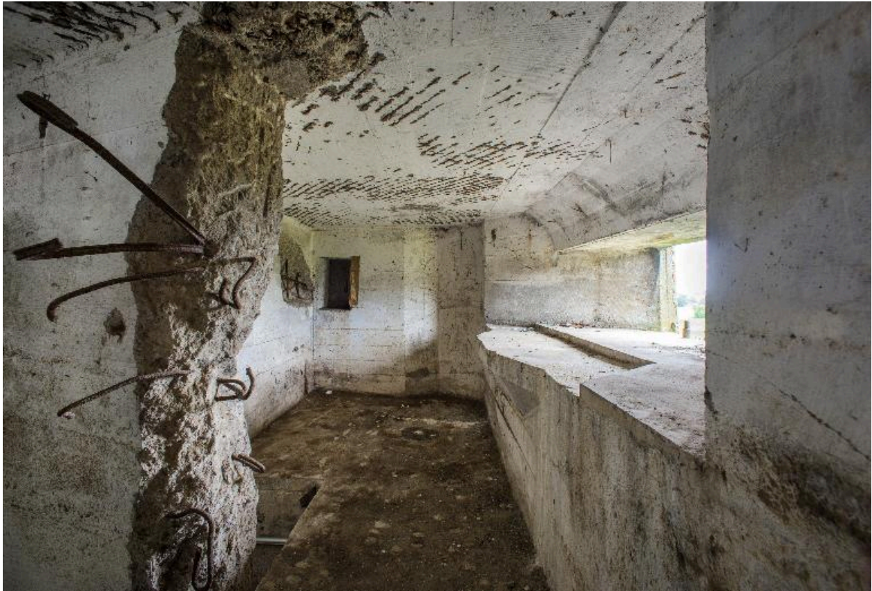
Premier étage, vue au grand-angulaire. A droite, l'appui pour mitrailleuse est. Hors-champs, à gauche, l'accès à la coursière de tir.
