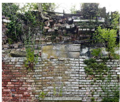
Elévation antérieure. Détail de la corniche cachant une embrasure de tir Phot. Jean-Marc Ramette IVR31_20145904827NUCA
