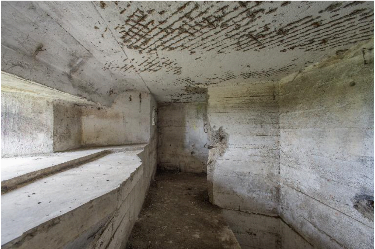
Premier étage, vue au grand-angulaire. A gauche, appui pour mitrailleuse est. Au fond l'accès à la coursière de tir, à droite, ouverture vers le rez-de-chaussée
