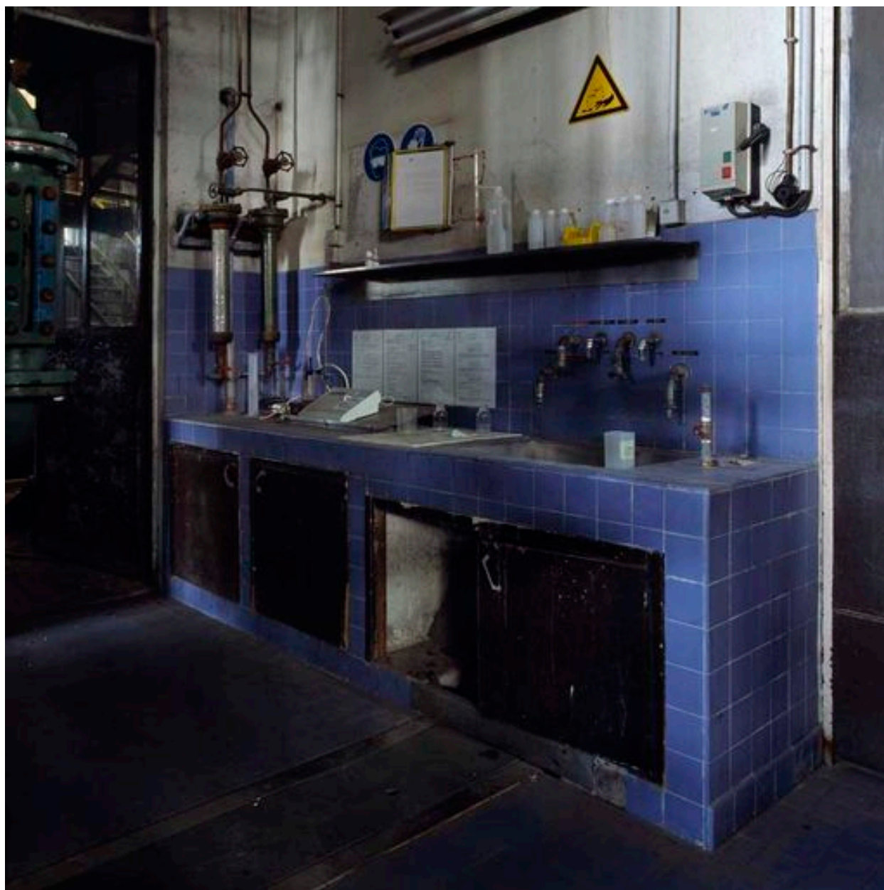
Paillasse au premier étage de la centrale.
