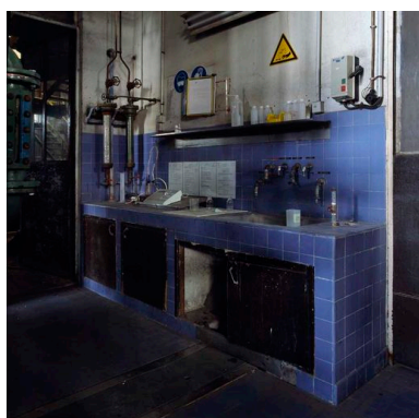
Paillasse au premier étage de la centrale. Phot. Thierry Lefébure IVR22_20106000864XA
