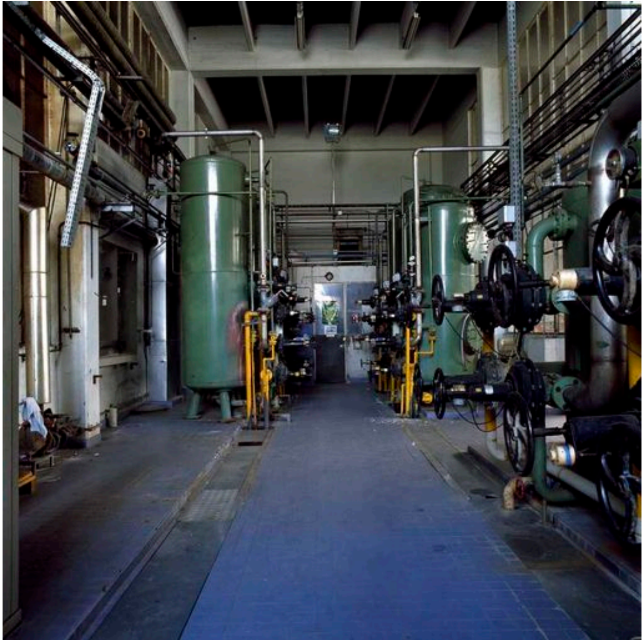
Chaudière au premier étage de la centrale.
