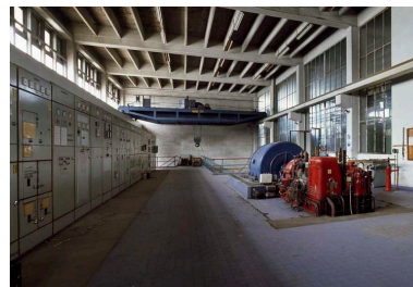
Turbine et alternateurs au premier étage de la centrale. Phot. Thierry Lefébure IVR22_20106000874NUCA
