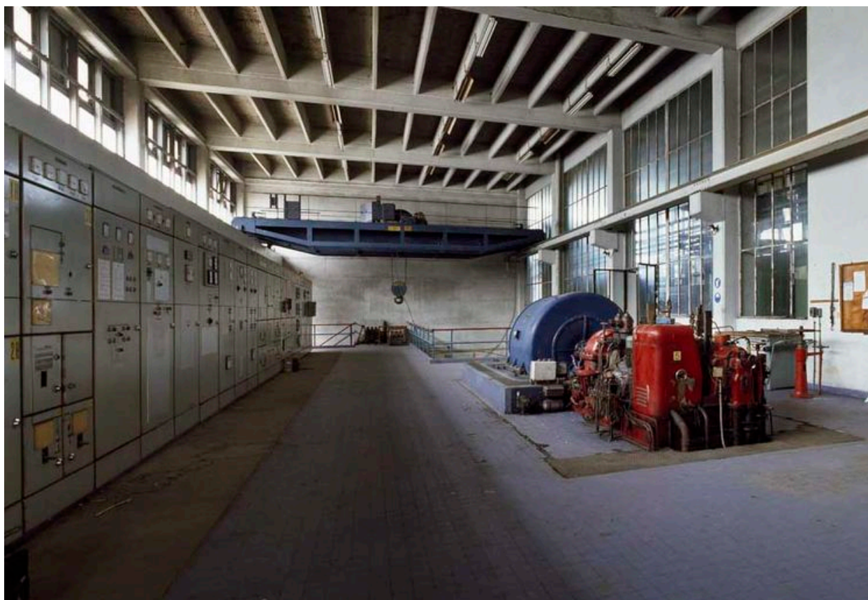
Turbine et alternateurs au premier étage de la centrale.
