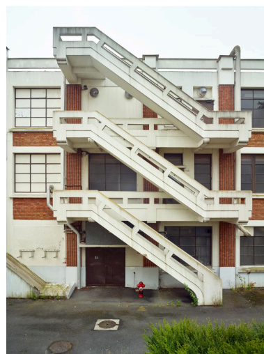
Escalier de distribution extérieur situé sur l'élévation nord de l'atelier de fabrication (G). Phot. Pierre Thibaut IVR32_20225900668NUCA
