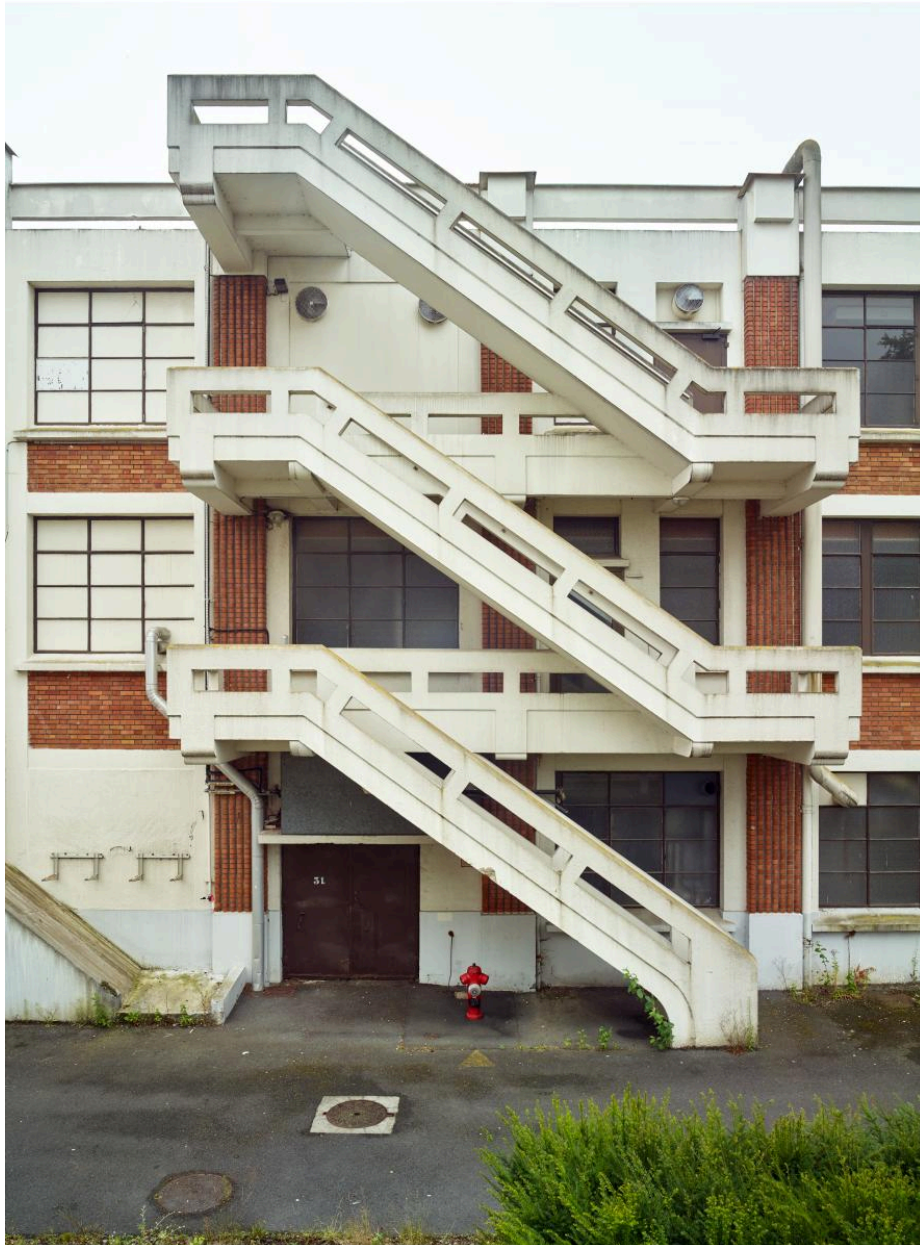
Escalier de distribution extérieur situé sur l'élévation nord de l'atelier de fabrication (G).
