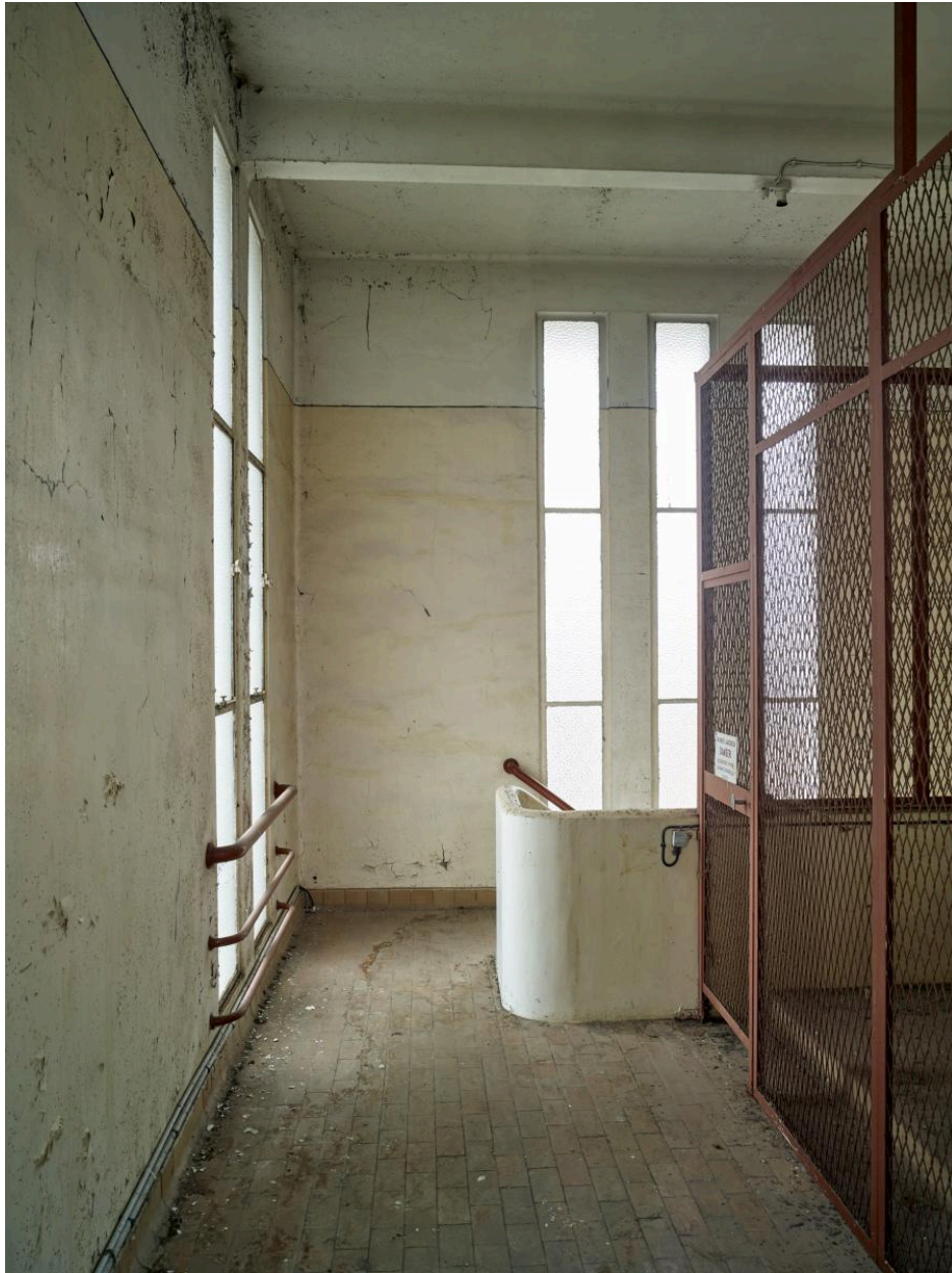
Vue intérieure de la tour d'angle de l'atelier de fabrication (H). Le dernier palier. A droite, la cage du monte-charge.
