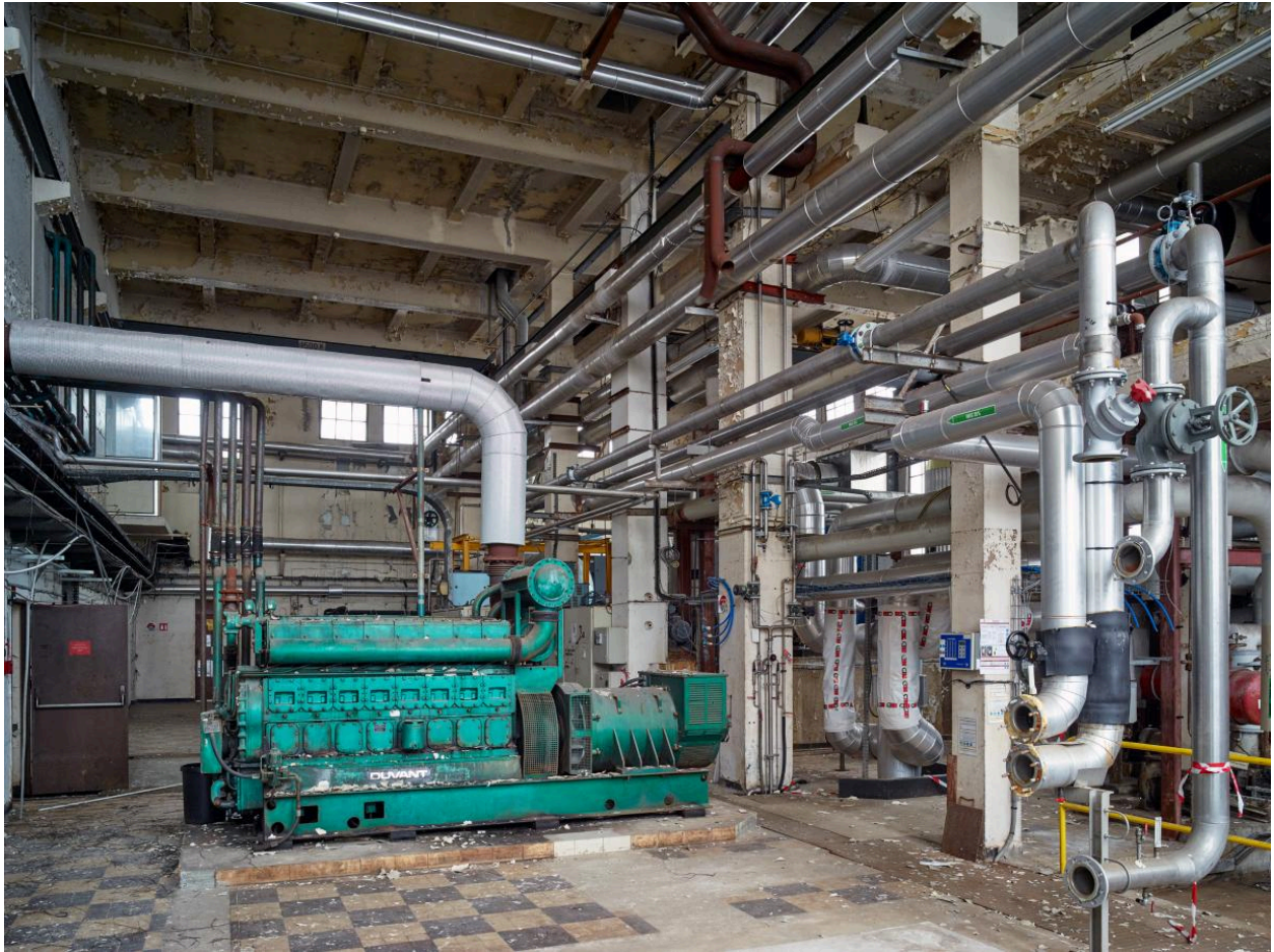
La chaufferie (A), vue intérieure. Au centre un moteur Duvant (Valenciennes) de 1978.
