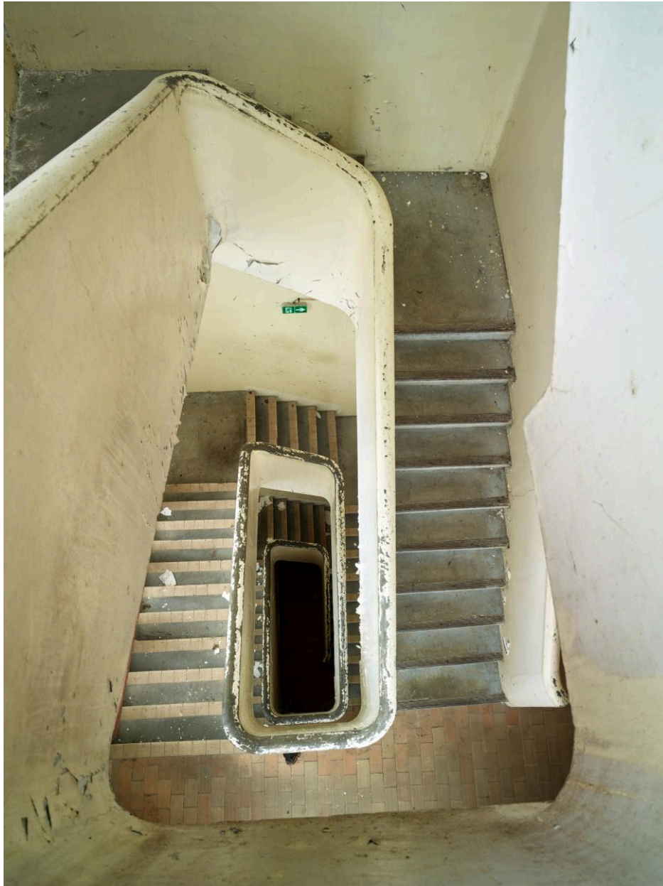
Vue intérieure de la tour d'angle de l'atelier de fabrication (H). Vue plongeante de la cage d'escalier depuis le dernier palier.
