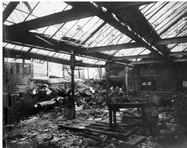
Photographie des ateliers en ruine (atelier en rez-de-chaussée implanté en fond de cour) prise avant les travaux de reconstruction (AD Aisne). Phot. Pillet Frédéric IVR22_20040200585NUCAB
