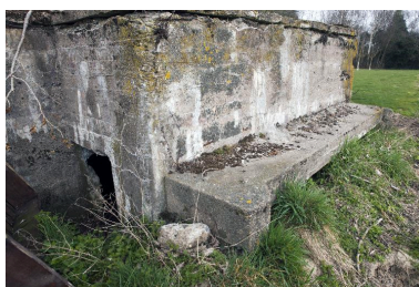
Banquette de tir vers le nord-est. A gauche, l'entrée latérale ouest Phot. Pierre Thibaut IVR31_20155900631NUCA
