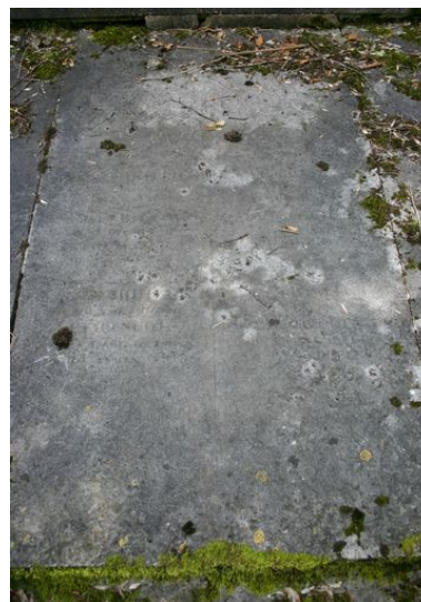
Dalle fermant le caveau et sur laquelle sont gravées les épitaphes des défunts de la famille. Phot. Caroline Vincent IVR22_20078000970NUCA
