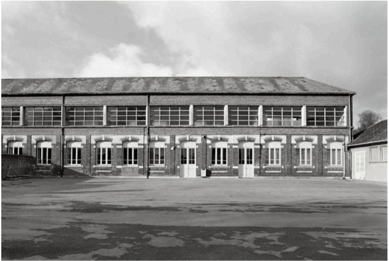
Vue de face de la façade sur cour du bâtiment des classes.
