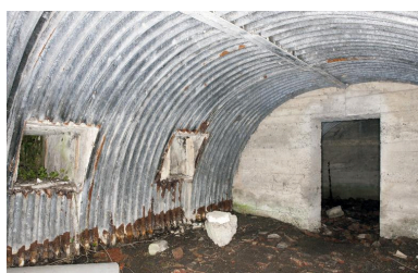
Vue intérieure de la salle Sud-Est depuis l'entrée Phot. Pierre Thibaut IVR31_20155900613NUCA
