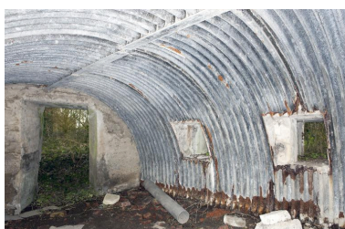
Vue intérieure de la salle Sud-Est, vers l'entrée Phot. Pierre Thibaut IVR31_20155900614NUCA
