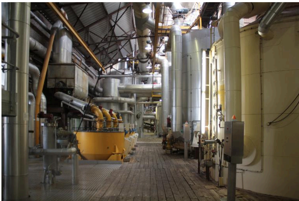
Vue générale de la "zone blanche" : cuite de cristallisation et turbines.
