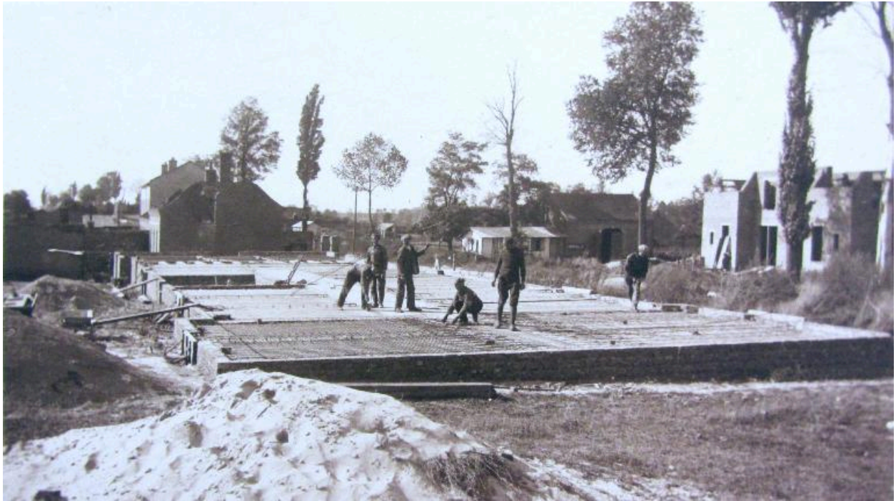
Pose de la dalle en béton armé du bâtiment de réfectoire de la sucrerie, 28 septembre 1920 (AD Somme ; 49 Fi 35).
