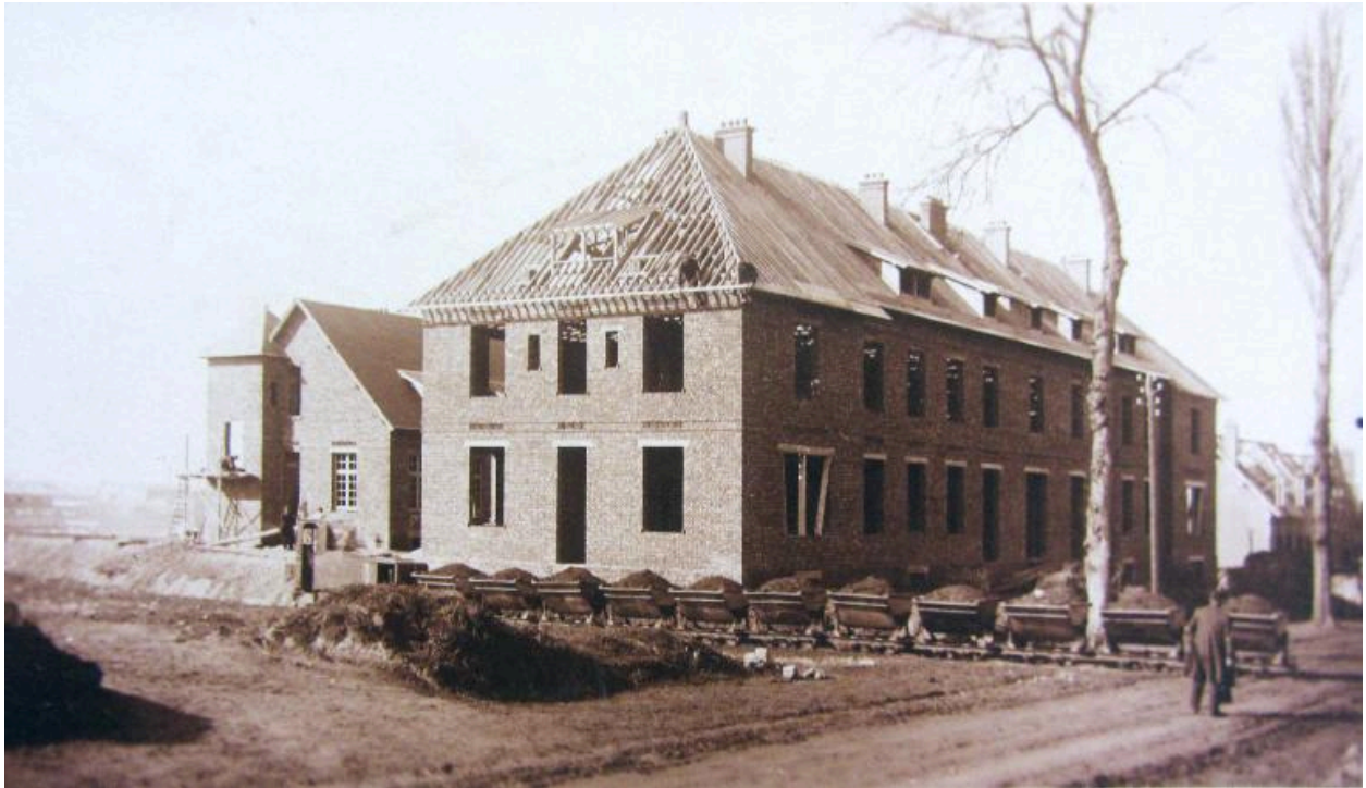
Vue de la cantine de la sucrerie en cours de construction, 30 mars 1921 (AD Somme ; 40 Fi 51).
